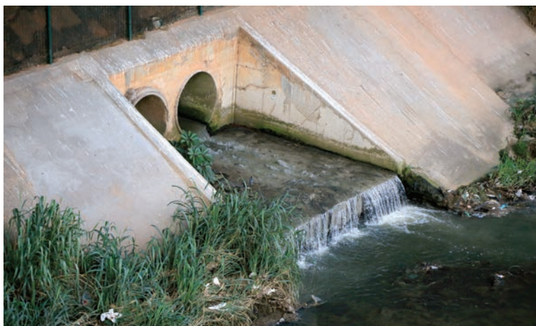
Esgoto sendo despejado em córrego em Salvador (BA). Foto de 2023.
